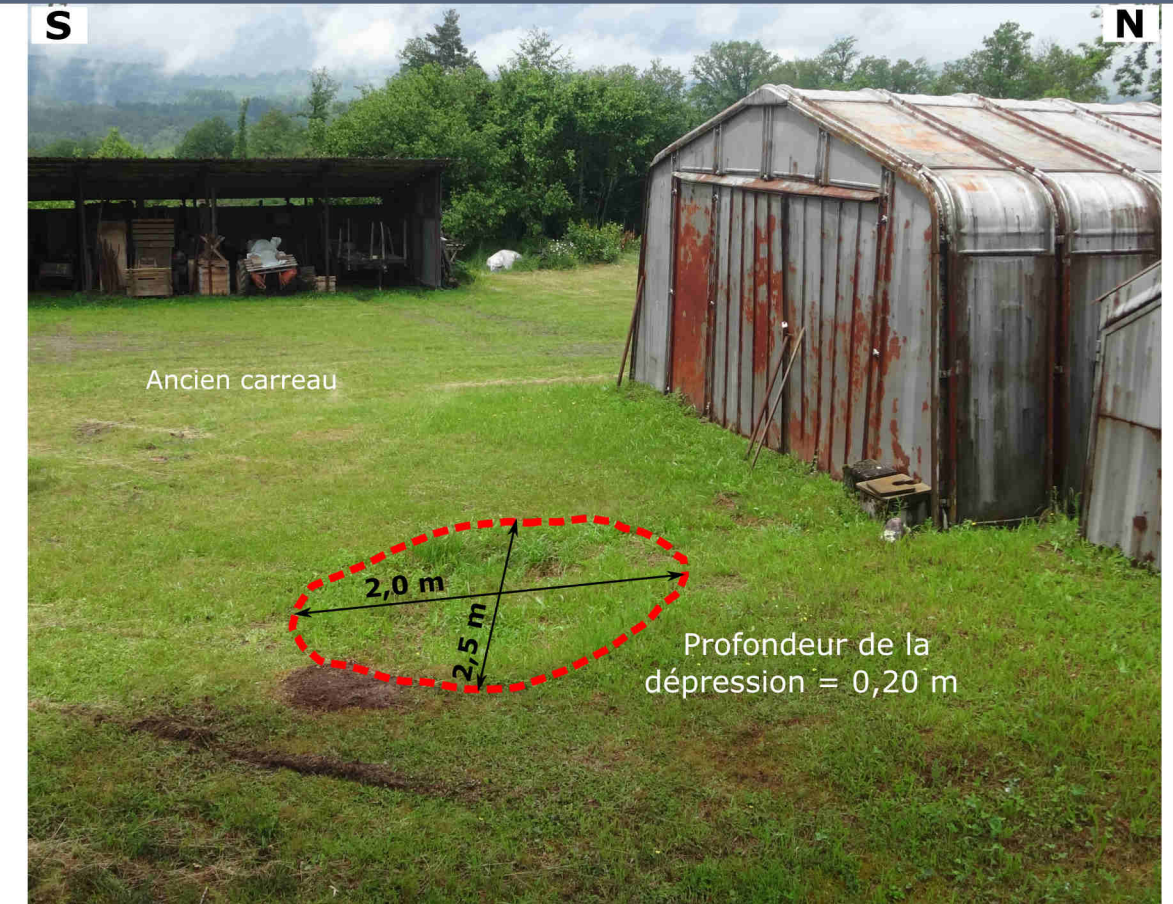
Zone de tassement des remblais au droit de l'ancien montage
